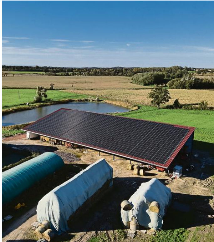
Terre et Lac développe déjà plus de 70 projets sur des toitures et des ombrières de parking dans la moitié sud du pays.
